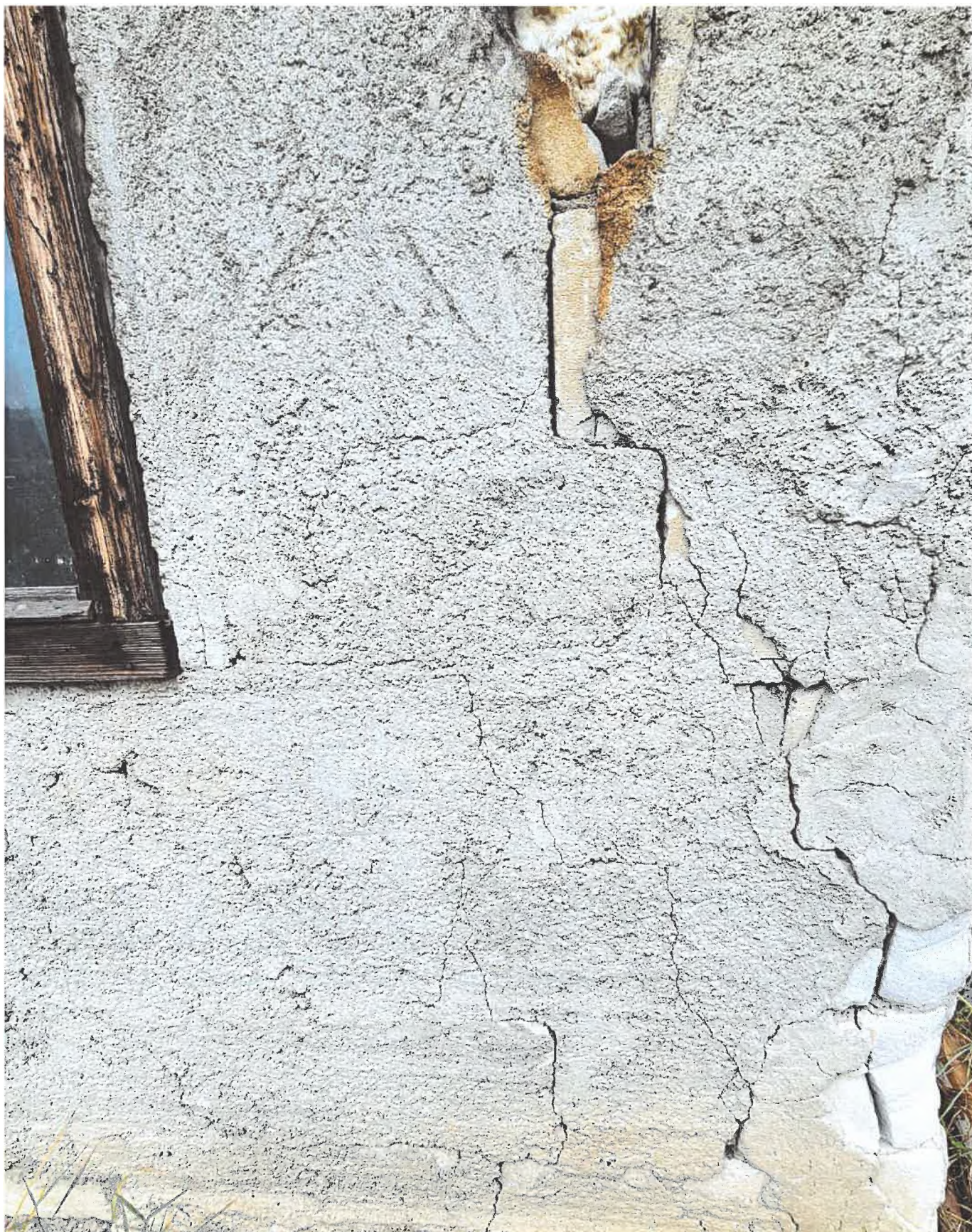
Foto 09 – Aspecte exterioare: vedere de ansamblu degradari
