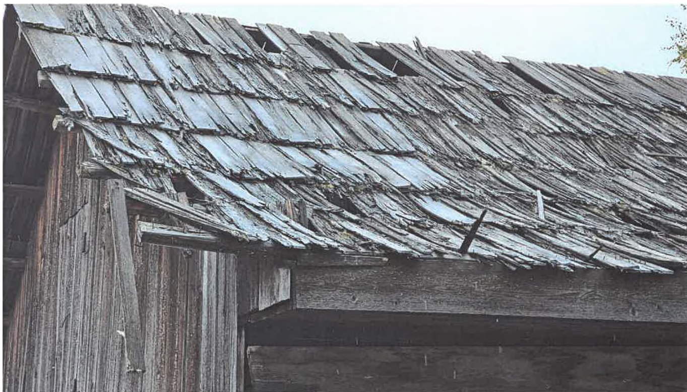
Foto 06 – Aspecte exterioare: vedere de ansamblu degradari
