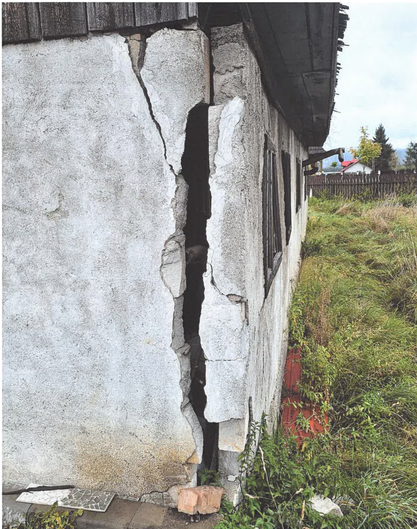
Foto 10 – Aspecte exterioare: vedere de ansamblu degradări
