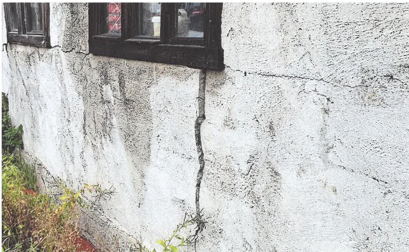
Foto 08 – Aspecte exterioare: vedere de ansamblu degradari
