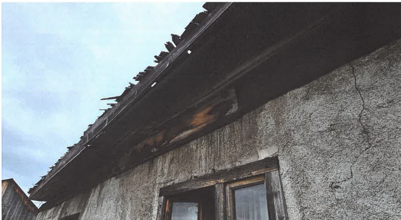
Foto 07 – Aspecte exterioare: vedere de ansamblu degradari
