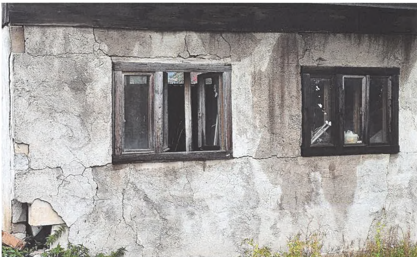
Foto 05 – Aspecte exterioare: vedere de ansamblu degradari
